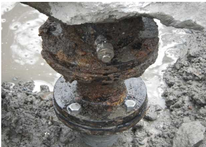
屋外埋設配管腐食
