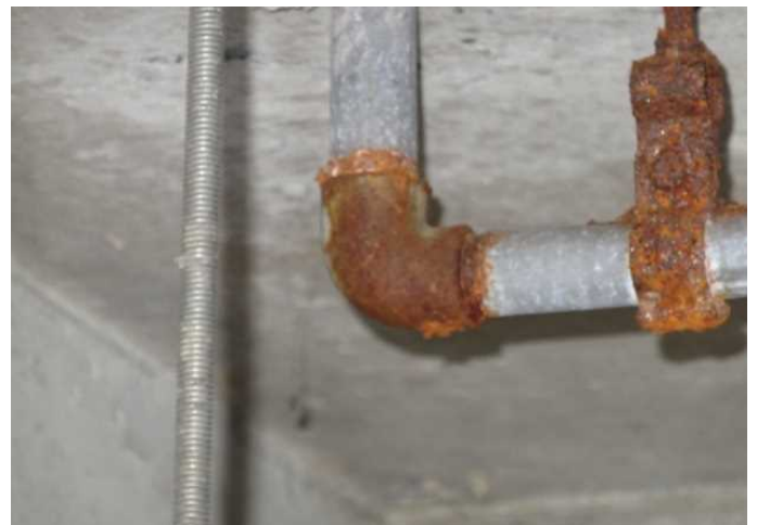
屋内排水管腐食
