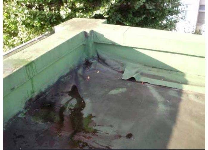
建物屋上防水劣化
