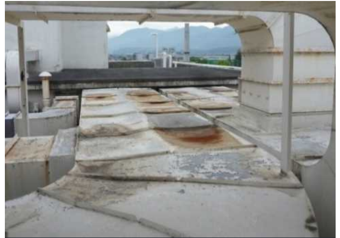
空調機排気ダクト腐食
