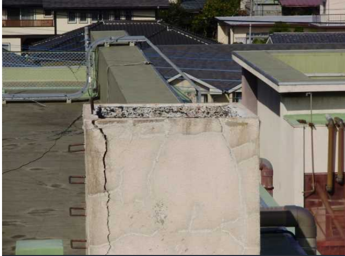
建物外壁クラック
