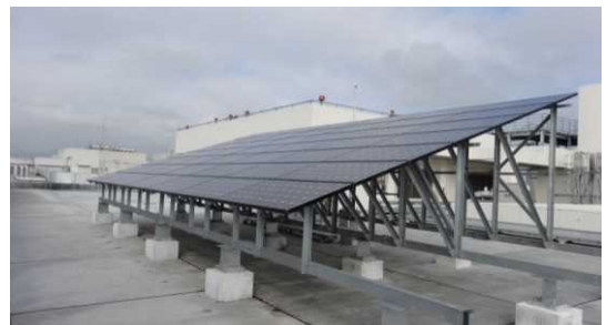
太陽光パネル（新病棟屋上）
