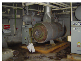
蒸気ボイラー(重油)
